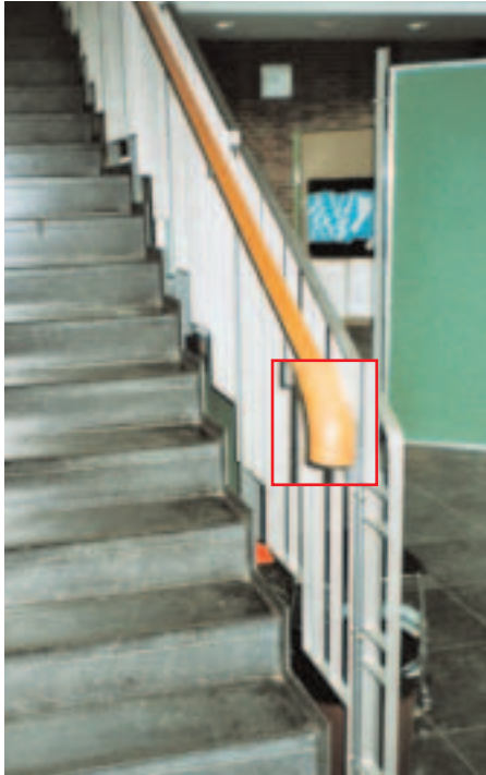
Handlaufende in Richtung Boden
