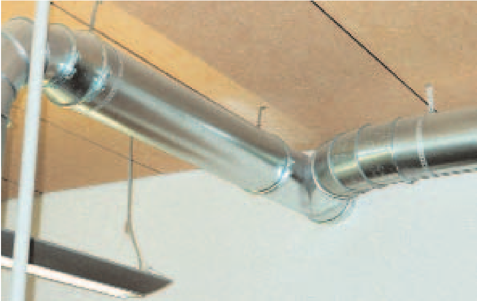
Fest installiertes Absaugsystem für den Maschinenraum
